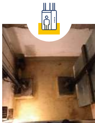
Filtración en fosos de ascensor
