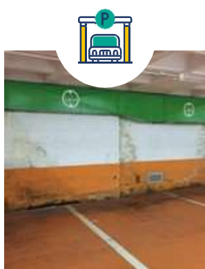
Filtración en garajes
